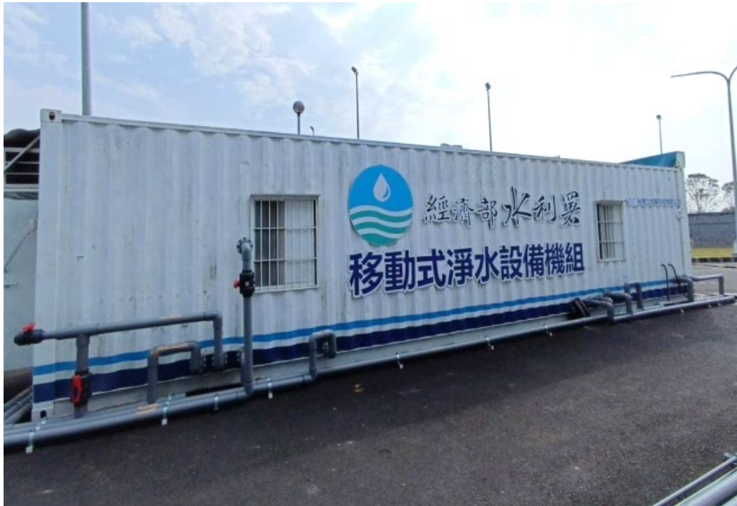
圖 6、高雄大樹污水廠移動式淨水設備
