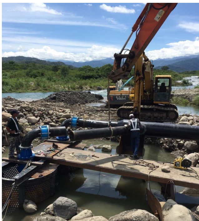
圖19 油羅溪伏流水臨時取水設施
