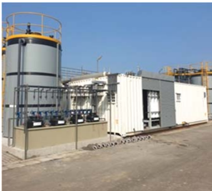
圖12 RO淨水設備
