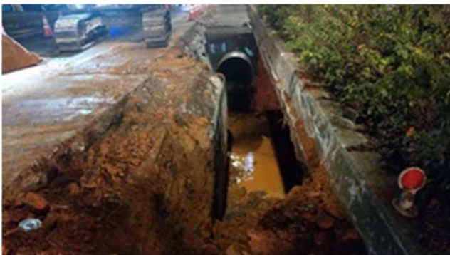
圖5 管(二)-2遇既有台電人孔管障
