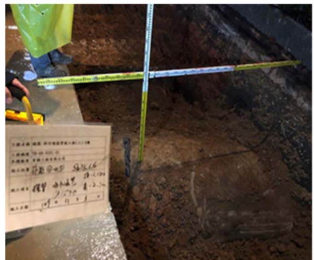
圖3 排水涵管管障致埋深不足
